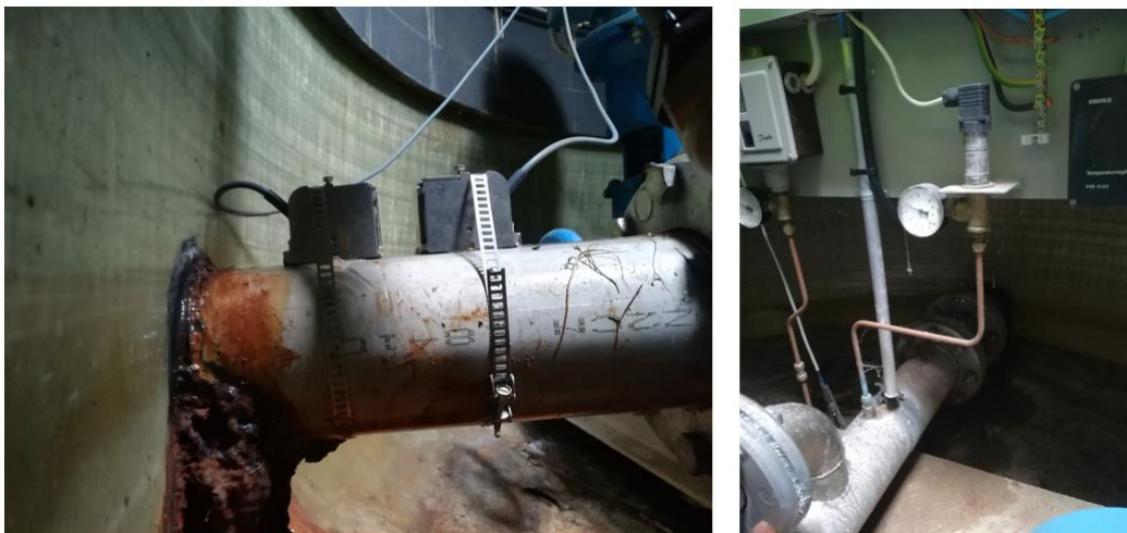
Kuva 4. Holapanlahden mittalaitteet asennettuna.
