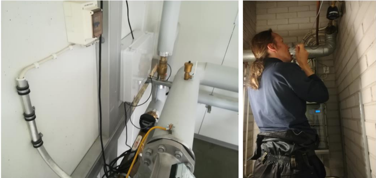
Kuva 6. Mestarintie 1 teollisuuskiinteistön asennukset lämmönjakohuoneeseen ja Ravintola Kokkimestarin vieressä olevaan siivouskomeroon.
